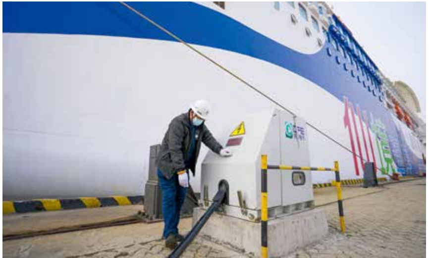
2022 年 3 月 16 日，烟台港成为中国北方首个非自有客滚船舶岸电常态化应用港口。图为“中华复兴”靠泊烟台港并实现岸基供电全程替代传统船舶燃料发电（烟台港 供图）
